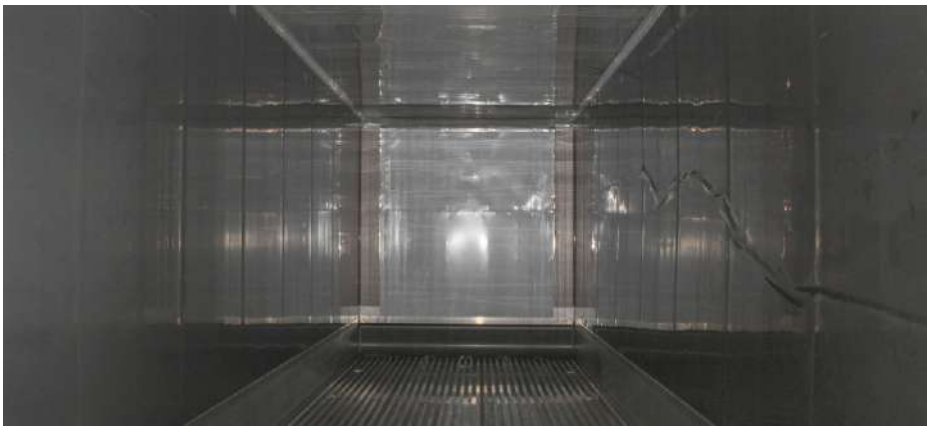
Actualmente vienen implementando un Contenedor Refrigerado
